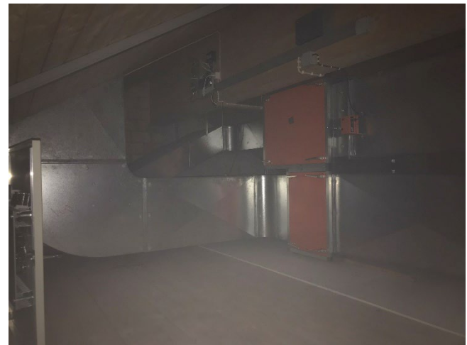
Lüftungsanlage für Aula
