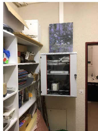
Server-Rack im UG
