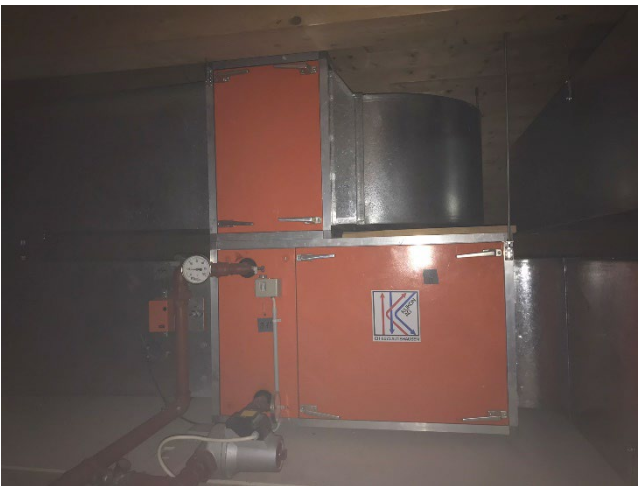
Lüftungsanlage für Aula
