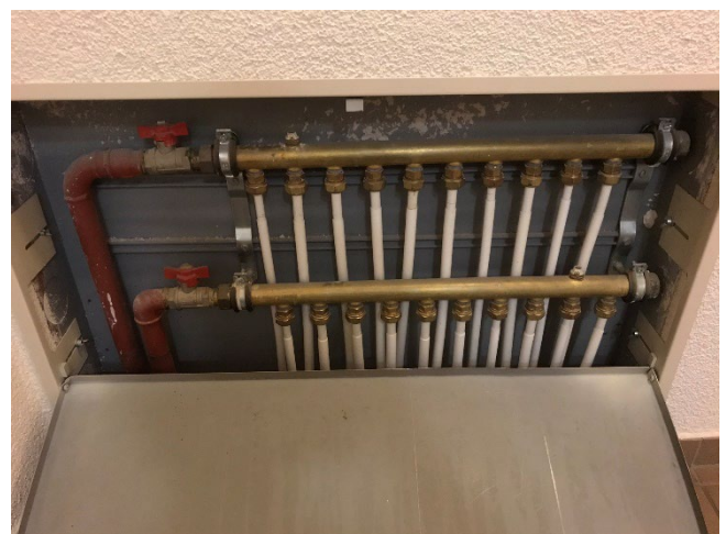
Heizkreisverteiler EG und OG auf Radiatoren
